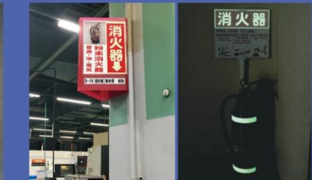
消火器の表示は遠くからも分かるように高い位置に。写真入りで種類もすぐ分かる。暗い場所では蓄光シートを利用。
