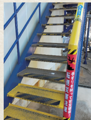
▲階段手すりへの転倒災害防止のための表示。
