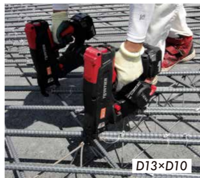
高速道路床版の鉄筋結束作業も2台同時使用でスピーディーに。
